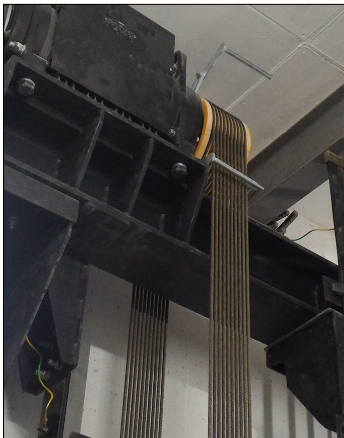
Безредукторная лебедка лифта внутри шахты
